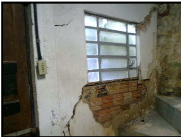
Parede com rachaduras e problemas de infiltração
