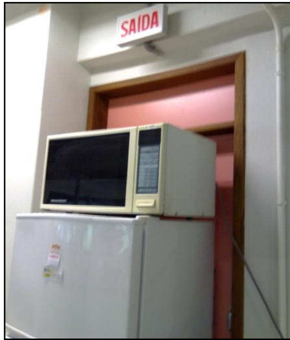
Obstrução de saída
