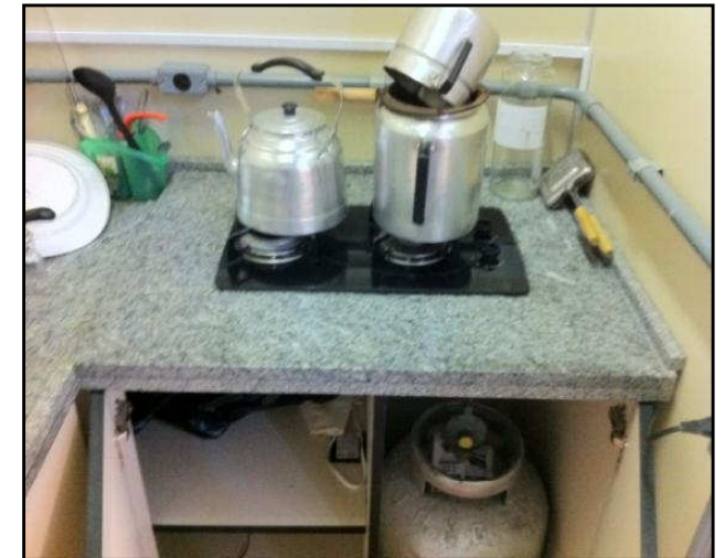
Instalação inadequada de botijão de gás
