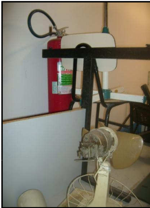
Obstrução do extintor
