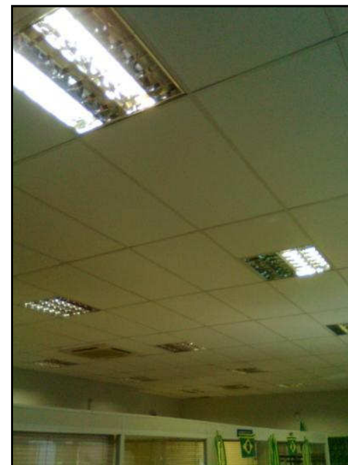
Sistema de iluminação: Lâmpadas fora do padrão e dificuldade de manutenção
