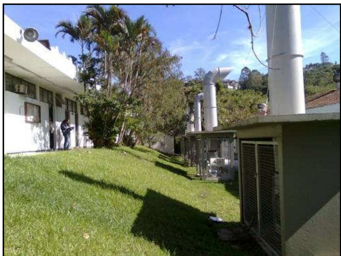
Exaustores voltados para ambiente de trabalho e elevado nível de ruído
